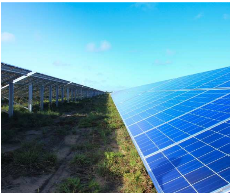
Parc photovoltaïque de Mios – 8,5MWc
